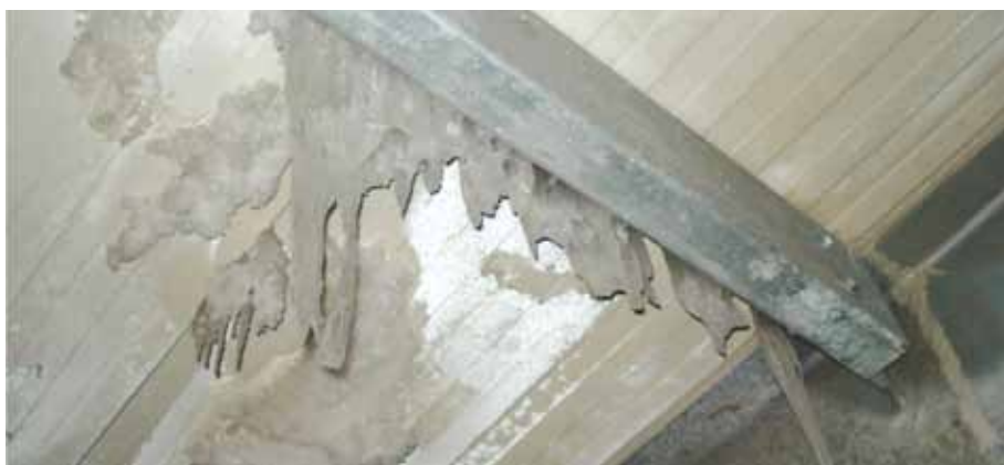
Figura 6. Formación de hielo en cubierta con fallas de sellado (fuente: G. Romero).
