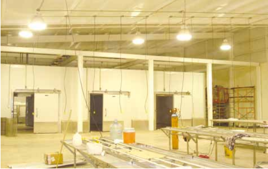
Figura 17. Vista general de los congeladores rápidos ( blast freezers ) terminados (fuente: G. Romero).
